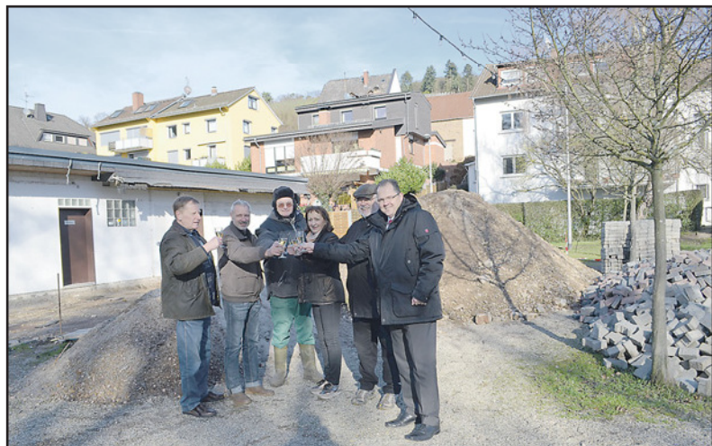
Kleiner Umtrunk mit Bürgermeister Patrick Kunkel auf den Beginn der Bauarbeiten am Weinprobierstand.
